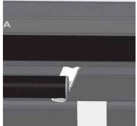
Abb. 3.24 Luftschieber ganz links, Verbrennungsluft geschlossen
